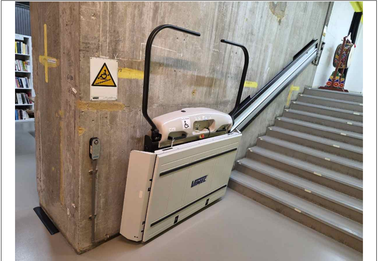
[별첨] 현재 설치된 장애인 승강기 사진
