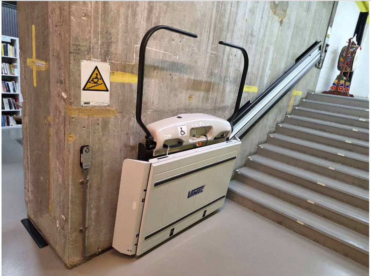
[별첨] 현재 설치된 장애인 승강기 사진
