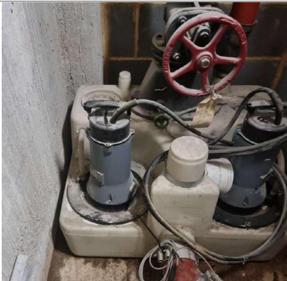
[별첨] 현재 설치된 펌프 사진
